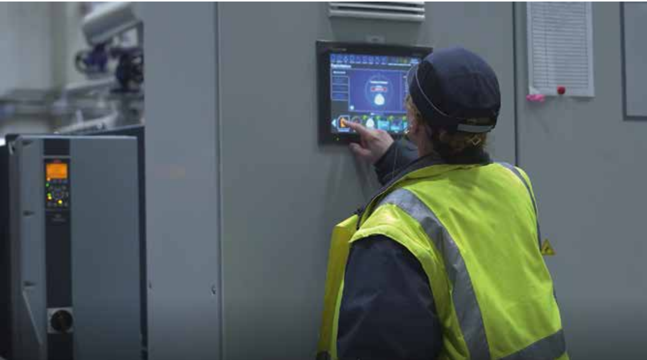
↳ Panneau de contrôle des consommations énergétiques de la Gigafactory.
